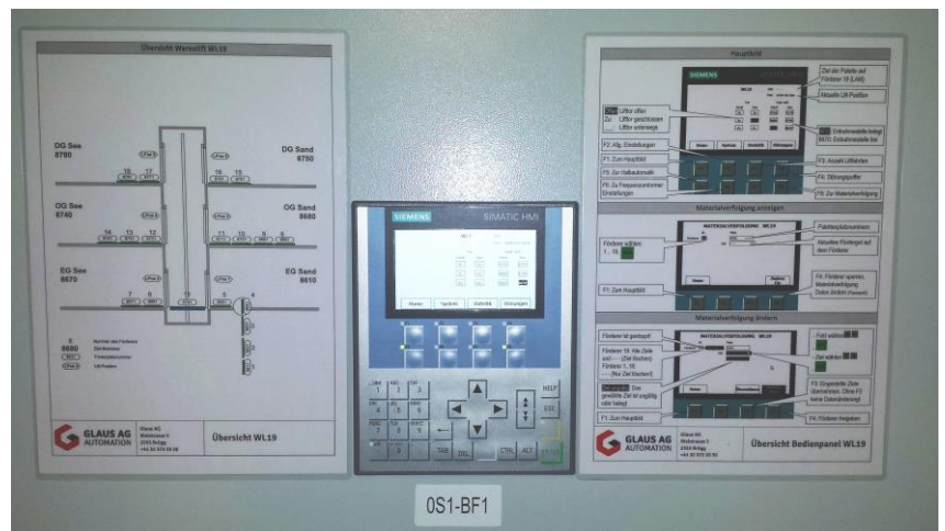
Bedienung am Hauptschrank
