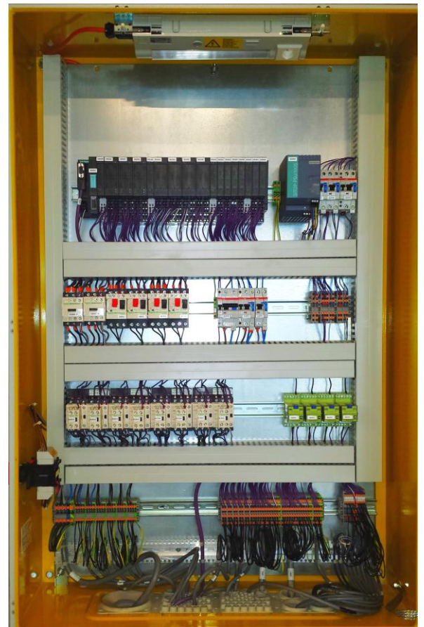
Dezentraler Schaltschrank mit S7-Safety-Modulen
